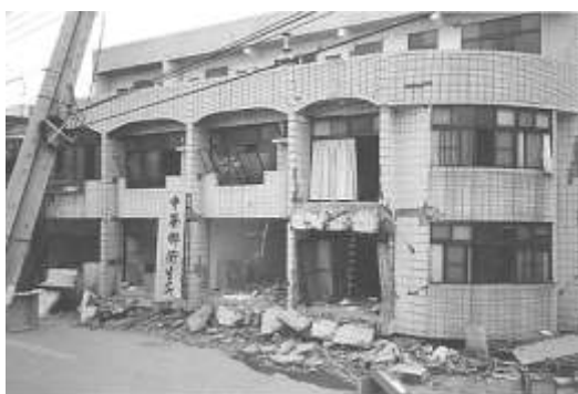
圖 7-8 毀損的中寮鄉衛生所 重建會提供
