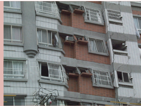
王朝二期受損情形
